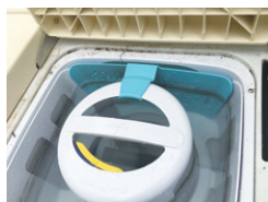
フィルター内部
